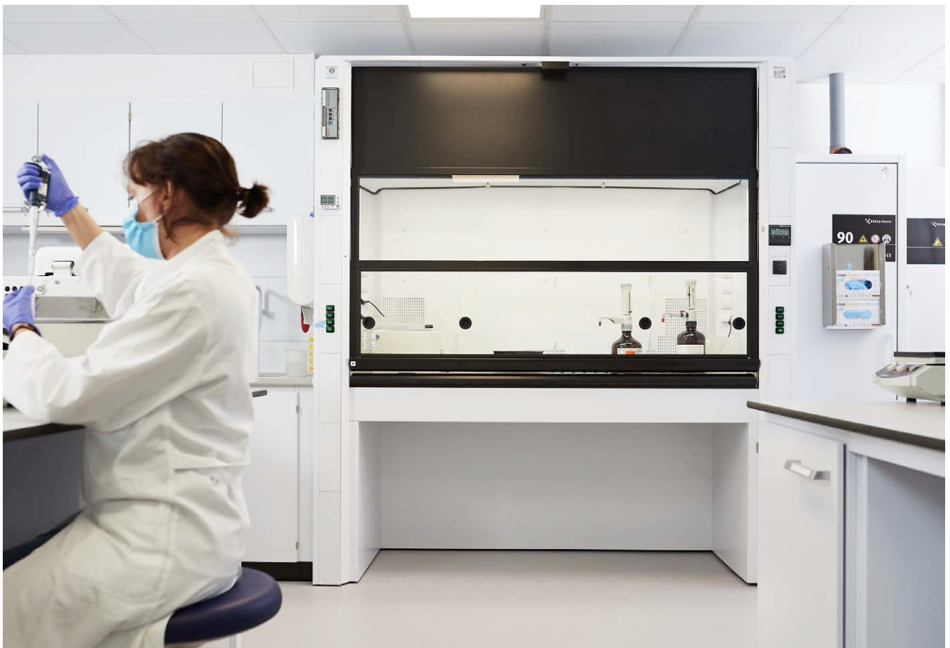
Dieser Laborabzug in der Erlanger Strahlenklinik ist auf Energieeffizienz ausgelegt und mit entsprechender Technik wie Regelsystemen und einer Frontschieber-Absenkungsautomatik ausgestattet. Bild: Köttermann
